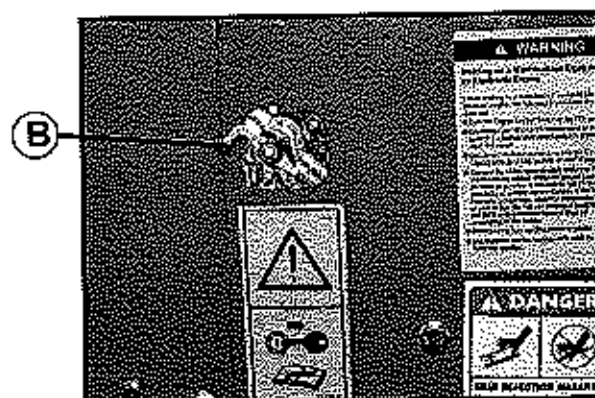
Seccionador en la posición "ON" - instalación lista para el servicio.
