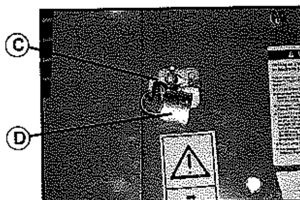
Seccionador en la posición "OFF" y paro. La instalación no puede trabajar
